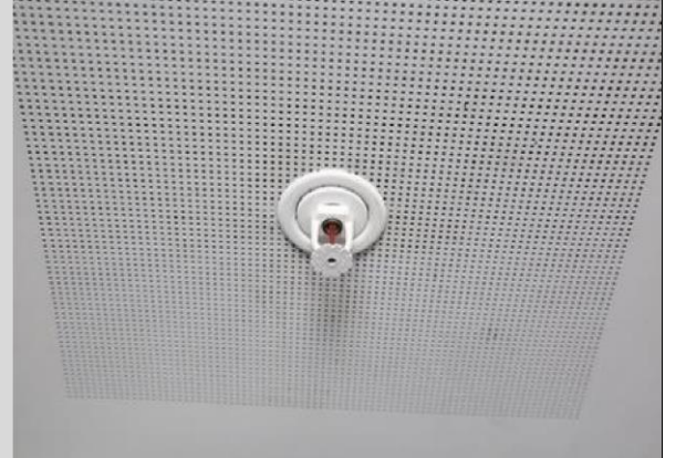
Yangın Söndürme Sistemleri (Kütahya Dumlupınar Üniversitesi, Türkiye)
