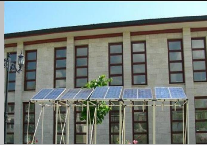
Güneş Panelleri Mühendislik Fakültesi
