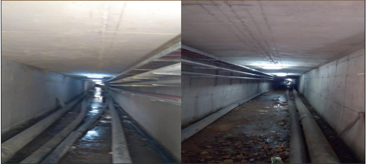
Fizyoterapi-Rehabilitasyon Hastanesi ve Olimpik Yüzme Havuzuna giden sıcak su kanalları (Kütahya Dumlupınar Üniversitesi, Türkiye)
