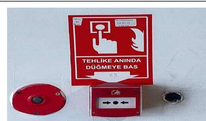
2.Yangın Alarmı -Yangın Söndürücü
