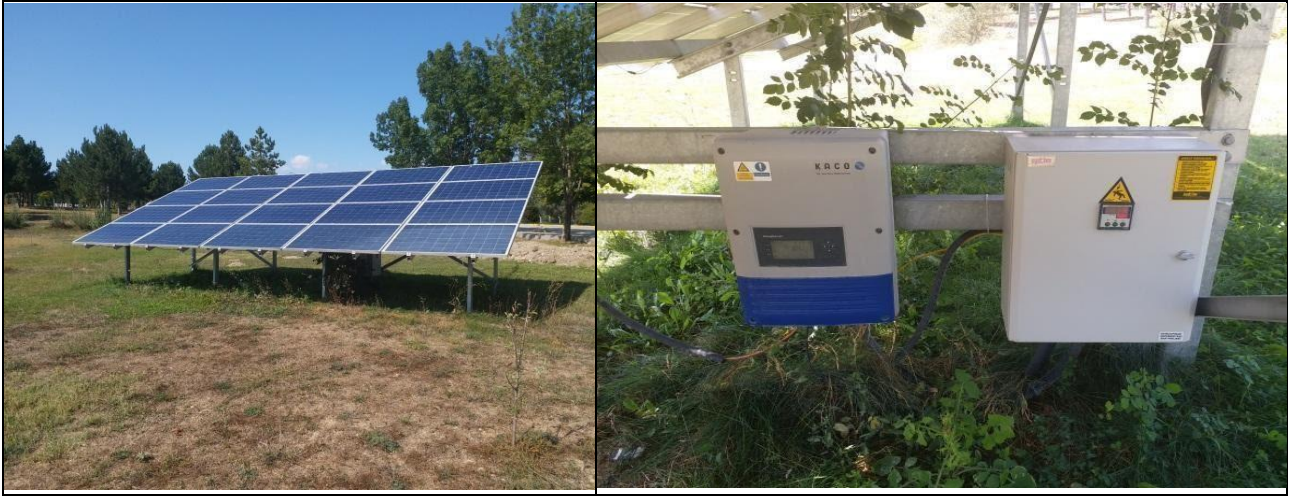
Kampüs elektrik şebekesine bağlı 5Kwh Solar PV enerji sistemi.
