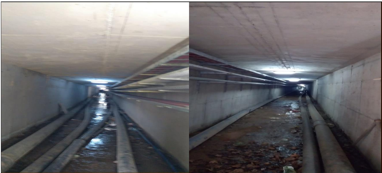
Fizyoterapi-Rehabilitasyon Hastanesi ve Olimpik Yüzme Havuzuna giden sıcak su kanalları (Kütahya Dumlupınar Üniversitesi, Türkiye)
