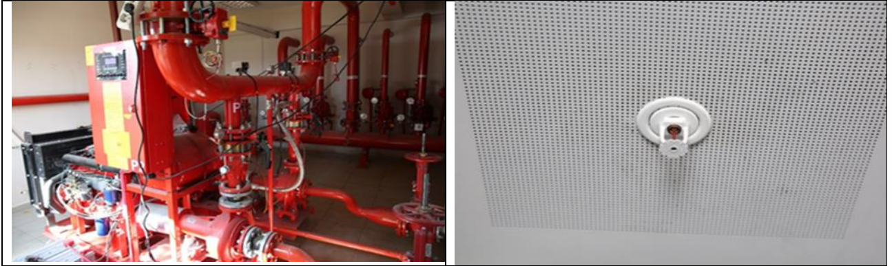
Yangın Söndürme Sistemi
