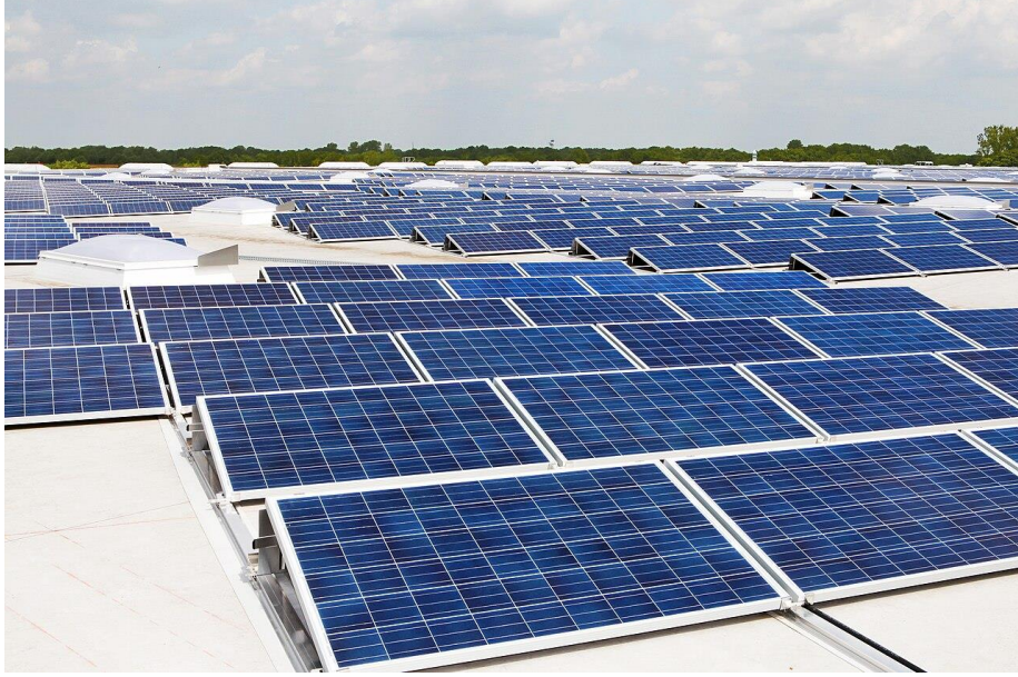
Şekil 11 Bir fabrika çatısına sıralı şekilde yerleştirilmiş güneş panelleri
